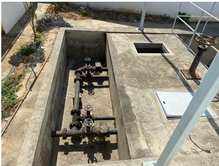
Figura 18: ETE por Filtros Anaeróbicos.
