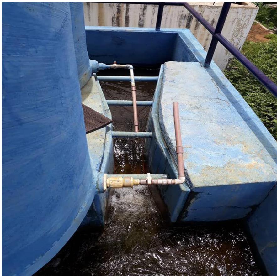
Figura 6: ETA 1 Calha Parshall usada na etapa de coagulação.
