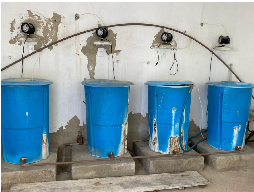
Figura 21: ETE por Filtros Anaeróbicos.
