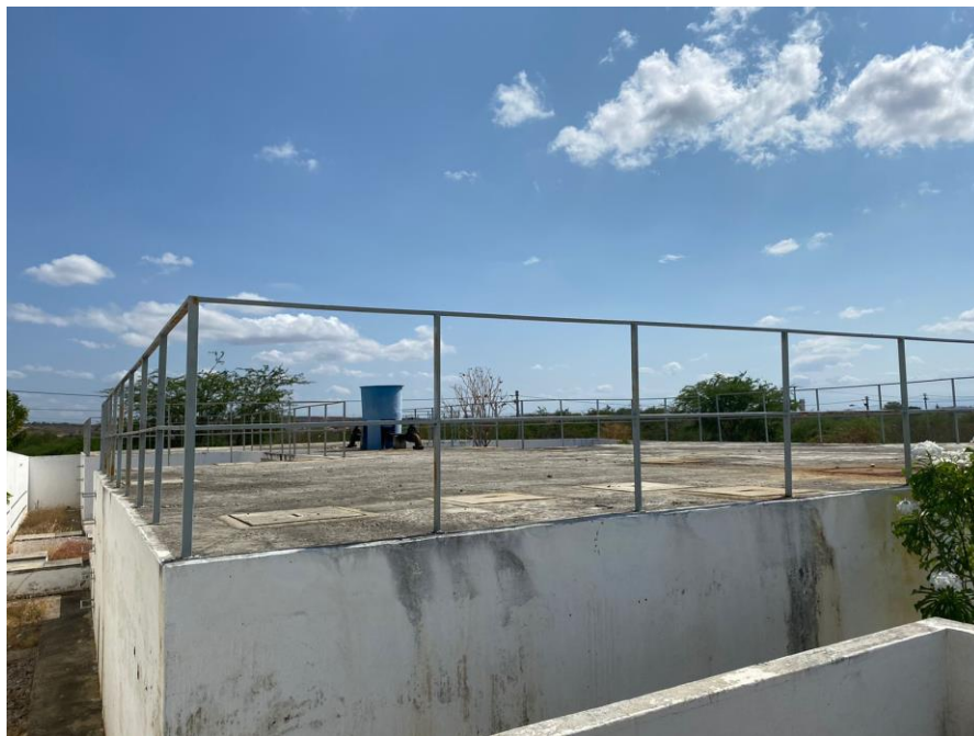
Figura 20: ETE por Filtros Anaeróbicos.
