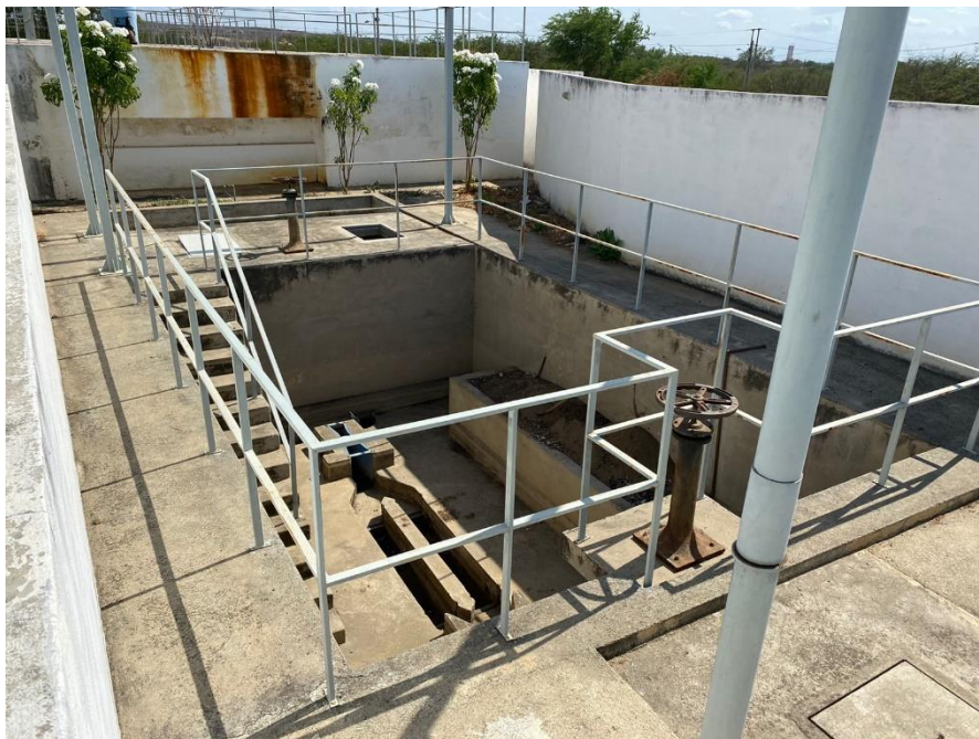
Figura 19: ETE por Filtros Anaeróbicos.
