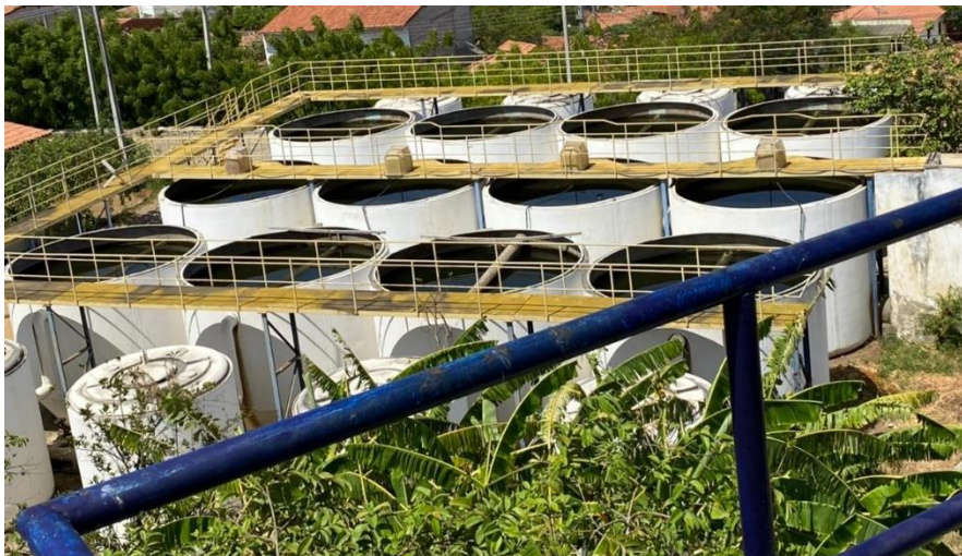
Figura 13: ETA 2 Floculadores, decantadores, e filtros.
