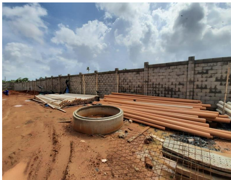
Figura 4: Tubos de PVC expostos ao tempo e em contato com o solo. Fonte: próprio autor, 2022.
