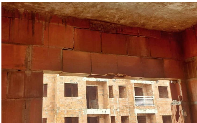
Figura 6: Verga da janela colapsou por falta de graute. Fonte: próprio autor, 2022.
