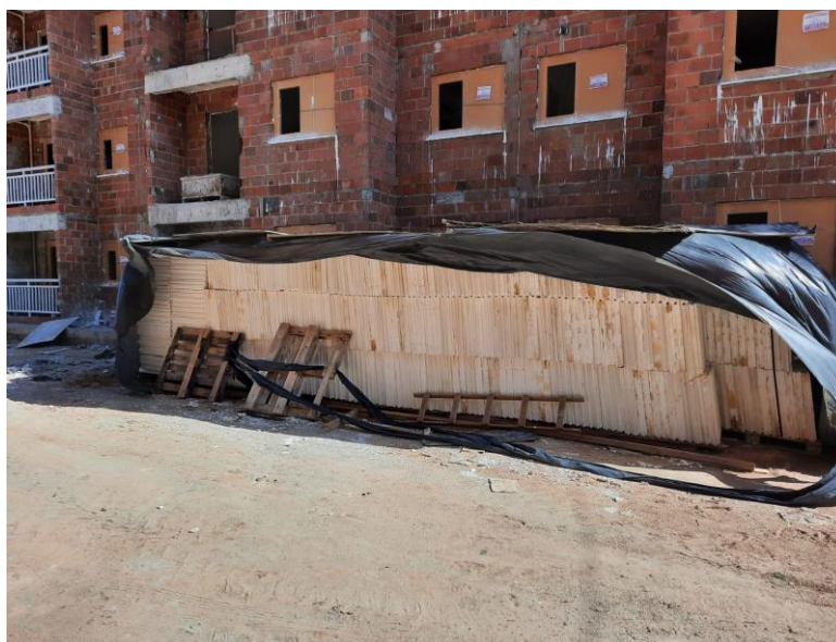
Figura 1: Placas de gesso expostas ao intemperismo. Fonte: próprio autor, 2022.
