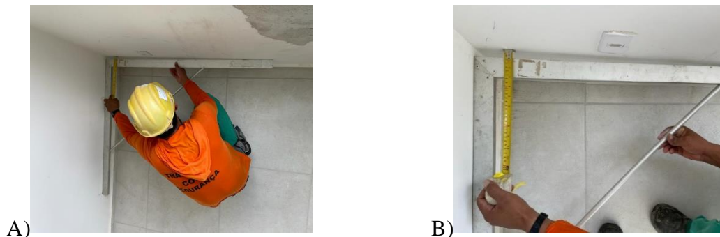
Figura 13 – Parede 2 cm fora de esquadro não atendendo a requisitos da norma
