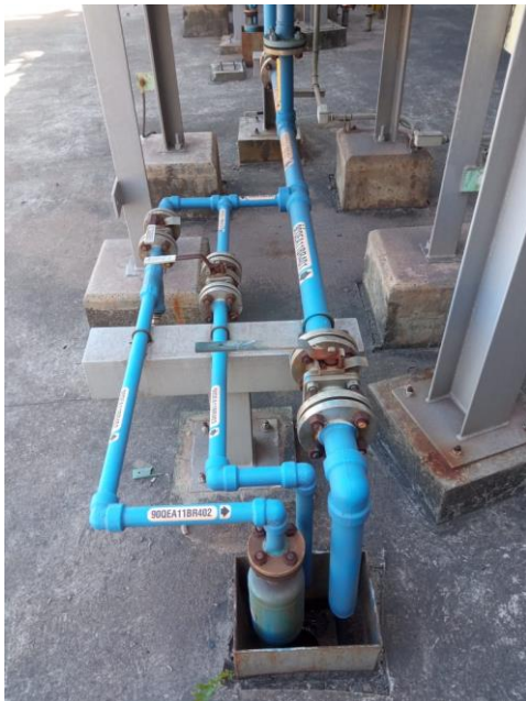
Figura 4: Tubulação de ar comprimido
