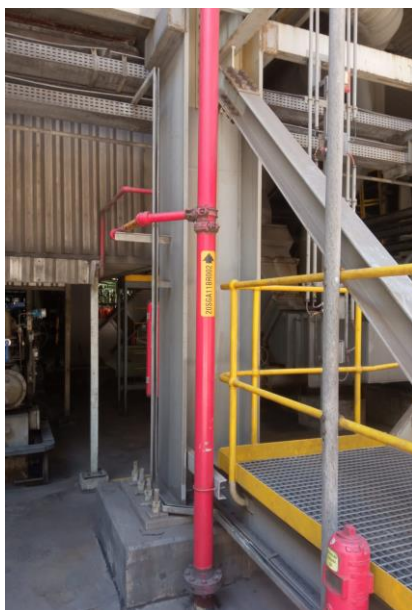
Figura 5: Tubulação de combate a incêndio
