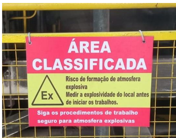
Figura 11: Sinalização de área classificada/caldeira
