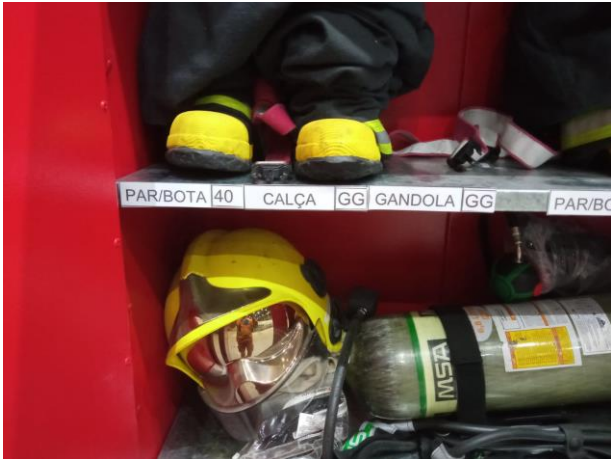
Figura 18: Armário de emergência 01
