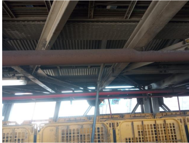
Figura 6: Tubulação de combate a incêndio sem pintura
