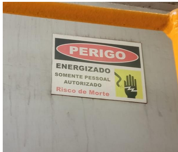
Figura 6: Sinalização de equipamentos energizados área comum
