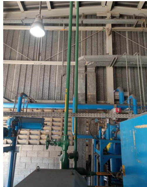
Figura 73: Tubulação de água
