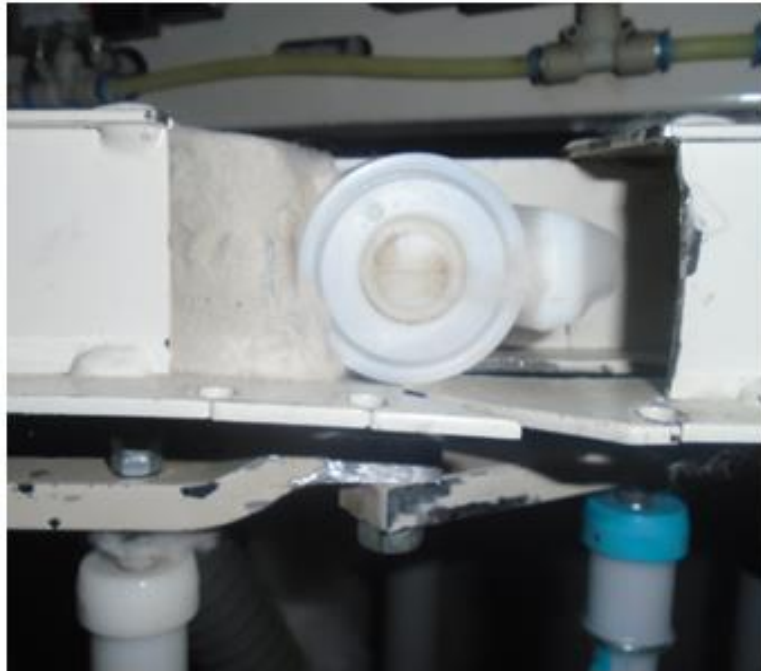
Figura 17 – Carrinho da esteira interna obstruído por sujidade
