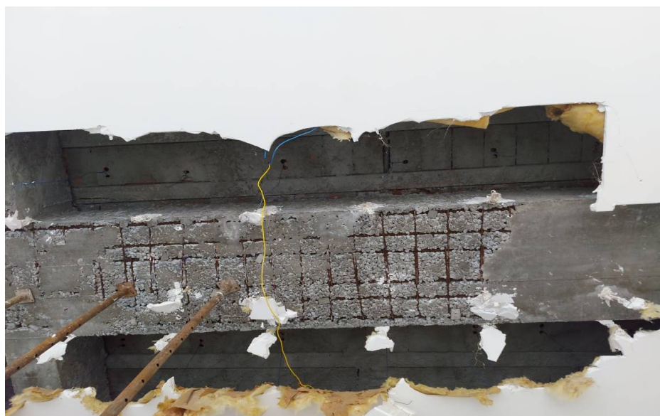
Figura 8. Presença de bicheiras por falta de adensamento
