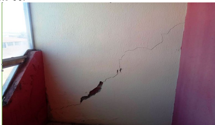
Figura 5. Verificação de falta de argamassa entre as juntas dos blocos do apartamento 06.
