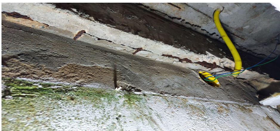
Figura 7. Corrosão do concreto e do aço viga em estudo
