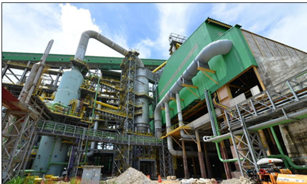
Figura 6–Vista do Sistema de limpeza de gás BFG no Alto Forno
