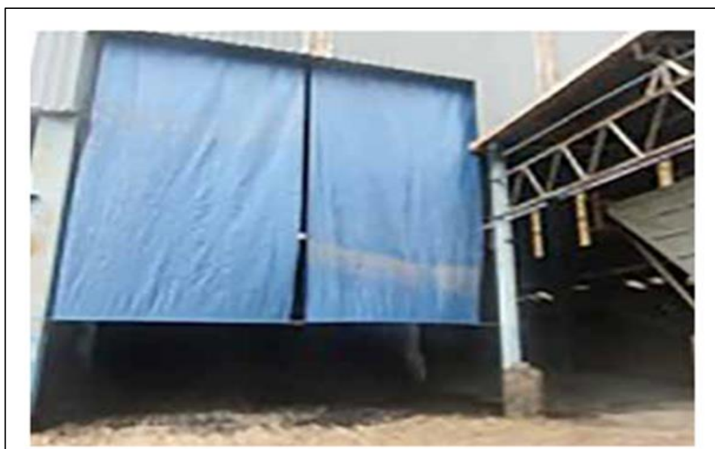
Figura 9-Depósito adequado para armazenamento de pó de ciclone
